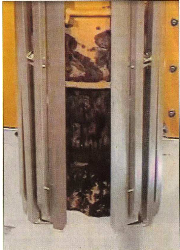
Ein im Bodenbereich stark beschädigtes Fass befindet sich gesichert im Greifer. Foto: Kernkraftwerk Brunsbüttel
